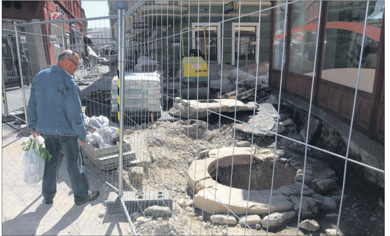
Že zdaj se pred vodnjakom, ki je zaradi varnosti na gradbišču ograjen, ustavljajo radovedni mimoidoči.
