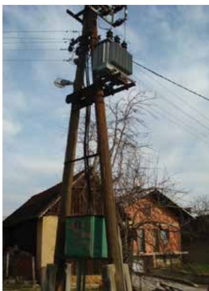
TP Lončarovci in NN omrežje pred obnovo
