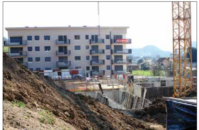
Predviden zaključek del na stavbi, ki se trenutno gradi, je do poletja prihodnje leto. (Foto: Benjamin Kanjir)
