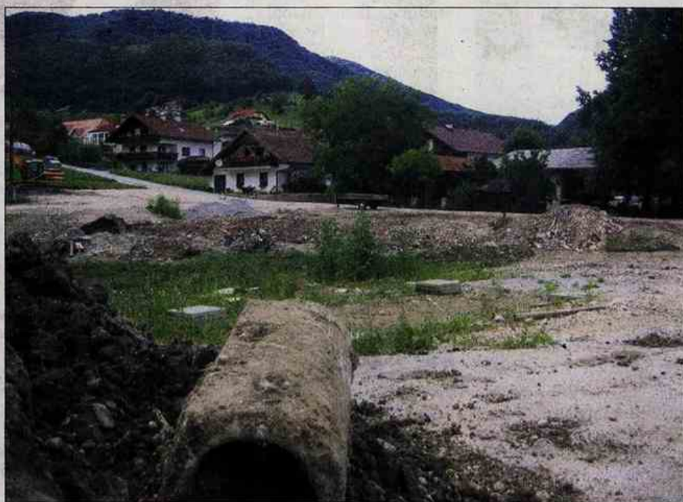
Sočane potrpežljivost počasi mineva. Namesto hiš že več let gledajo le razrite kupe zemlje, piko na i pa so dodali gradbeni odpadki.
