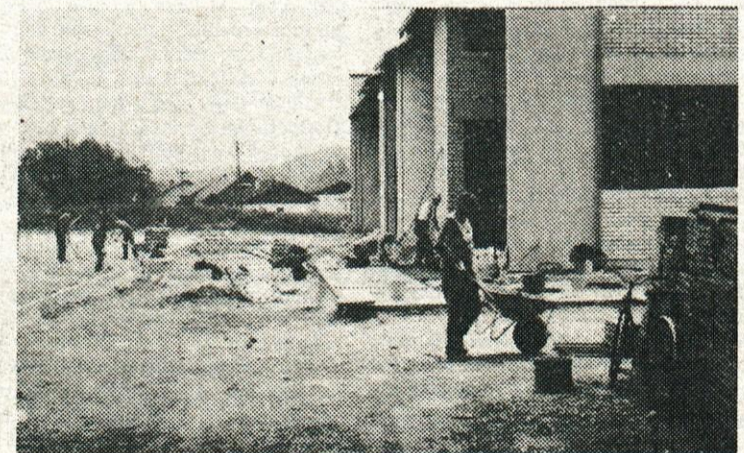
Denimo tole: prostor okrog novega objekta – stavbe športa bodo (so) nanovo prekrili s ploščami...
