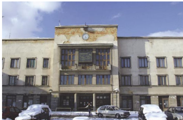
Slika 3: Občinska zgradba v Tuzli. Zaradi ugrezanja je prišlo do velikih poškodb na zgradbi, zato so jo morali uslužbenci leta 2004 zapustiti. Območje ugrezanja se razširja in danes obsega več kot 500 hektarov mestnega zemljišča (foto: Rahman Nurković).
