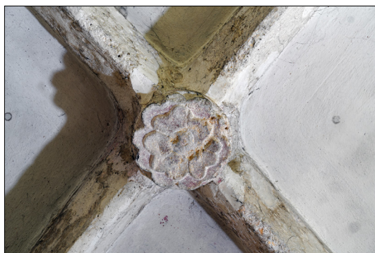
31. Slovenske Konjice, župnijska cerkev sv. Jurija, severna kapela, stik sklepnika z rebri v zahodni traveji (© ZRC SAZU, foto: Andrej Furlan)
