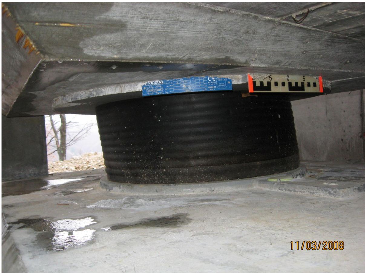
Slika 3.18: Deformirano ležišče tipa "Mageba" na viaduktu Barnica, HC, Razdrto – Vipava
