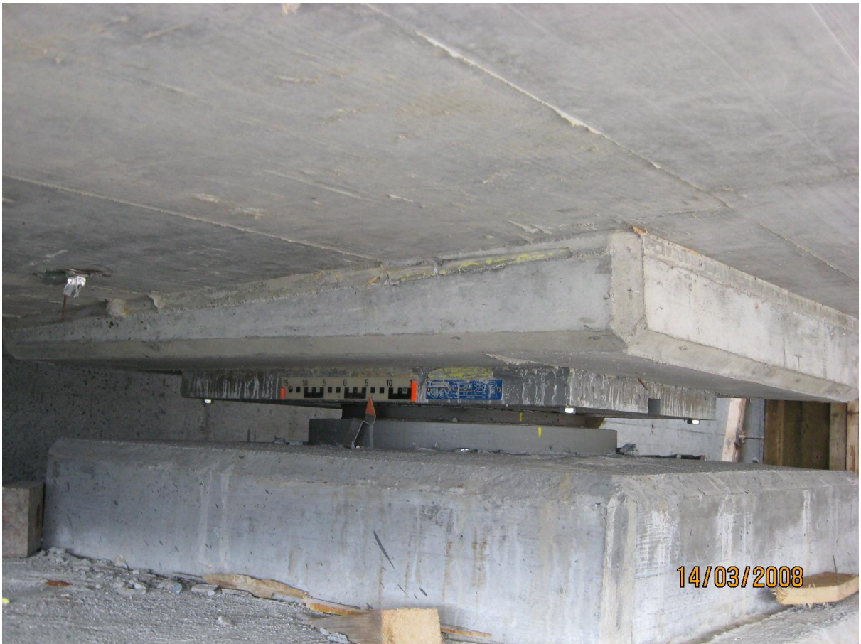
Slika 3.19: V vzdolžni smeri prečno ležišče "Mageba" na viaduktu Rebernice, HC Razdrto - Vipava
