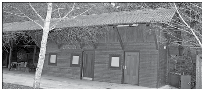
Strešno kritino iz salonitnih plošč na objektu ob športnih igriščih na Lazah je potrebno zamenjati. (Foto: Jože Miklavc)
