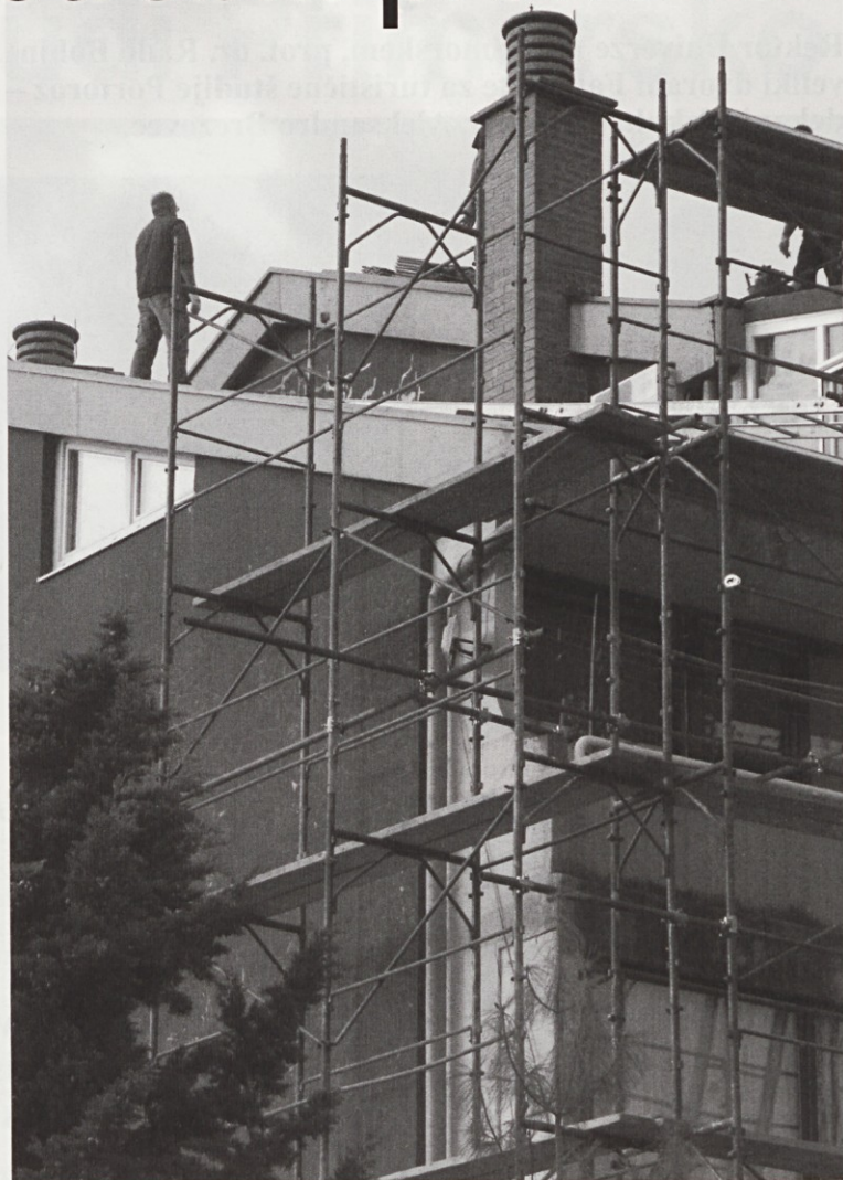
Stroški prekritja strehe na stanovanjskem stolpiču se lahko povzpnejo tudi do 25.000 evrov in več. FOTO: Primorski utrip.
