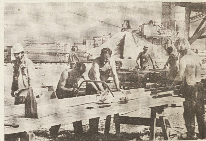
Tudi pri žagi je vse na svojem mestu, tako da je gradbišče res vzorno
