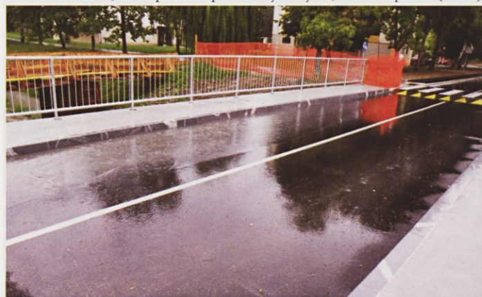
Občan Šentjurja je pred kratkim opozoril na vodo, ki ob deževju stoji na mostu.
