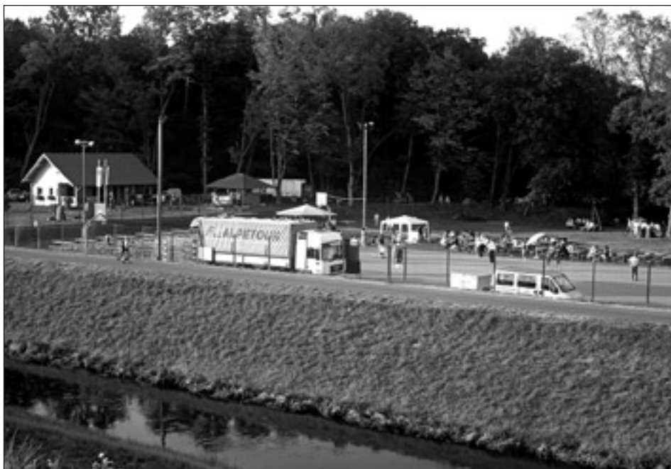
Na ptujski ranci se je gradnja rečnega pristanišča že pričela. V občini Markovci sta v okviru projekta Vitalizacija ptujskega jezera načrtovani dve vstopno-izstopni mesti v Zabovcih.
