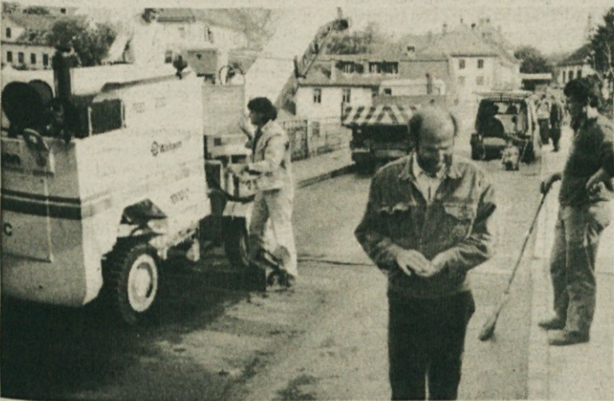
DA BO RAVEN MOST - V torek in sredo je bil novomeški kandijski most zaprt. Delavci Cestnega podjetja so po naročilu novomeške občine "ravnali" že hudo vegasto in izdelano asfaltno prevleko na tem mostu, ki se ob vsakem dežju spreminja v pravzaprav popeče. (Foto: J. D.)
