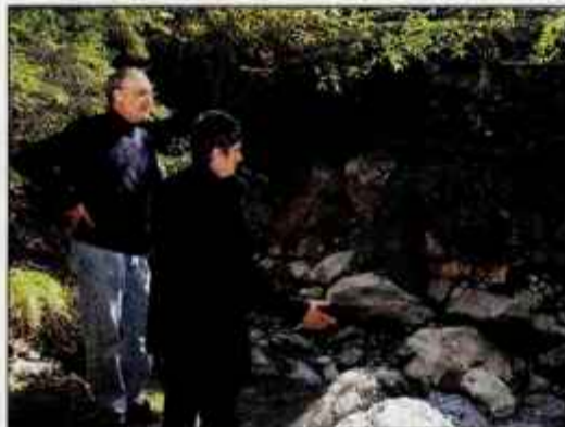
Janez Podobnik in Borut Sajovic na kraju, kjer je Tržiška Bistrica spodkopala temelje opornega zidu pod cesto v Dovžanovi soteski.
