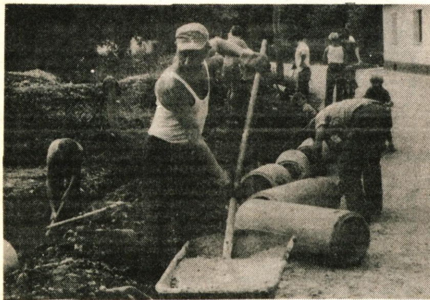
Cerklje — Pred dnevi so v krajevni skupnosti Cerklje s skupnimi močmi rešili težave, ki so jih povzročale meteorne vode v Ulici Ivana Hribarja. Delo so opravili prostovoljno, material in cevi pa je kupila krajevna skupnost. Že ta mesec nameravajo urediti avtobusno postajo, pripravljajo pa se tudi na gradnjo mrliških vežic. — J. Kuhar
