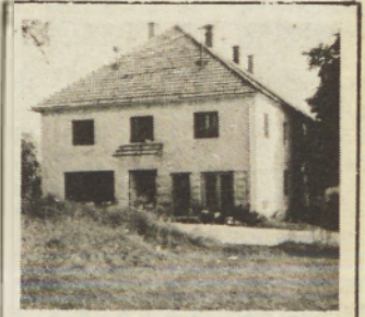
Ker je streha na združenem domu v Ženavlju, v katerem so prostori za gasilce in mladino ter Potrošnikova prodajalna dotrajana, so se vaščani odločili, da jo bodo obnavljali. Denar in material imajo pripravljen, z deli pa bodo pričeli na začetku poletja.
