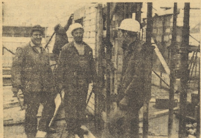
Na gradbišču v Keltheimu — Investitorji so dejali, da so z delom naših delavcev zelo zadovoljni, pa tudi delavci sami se niso preveč pritoževali.
