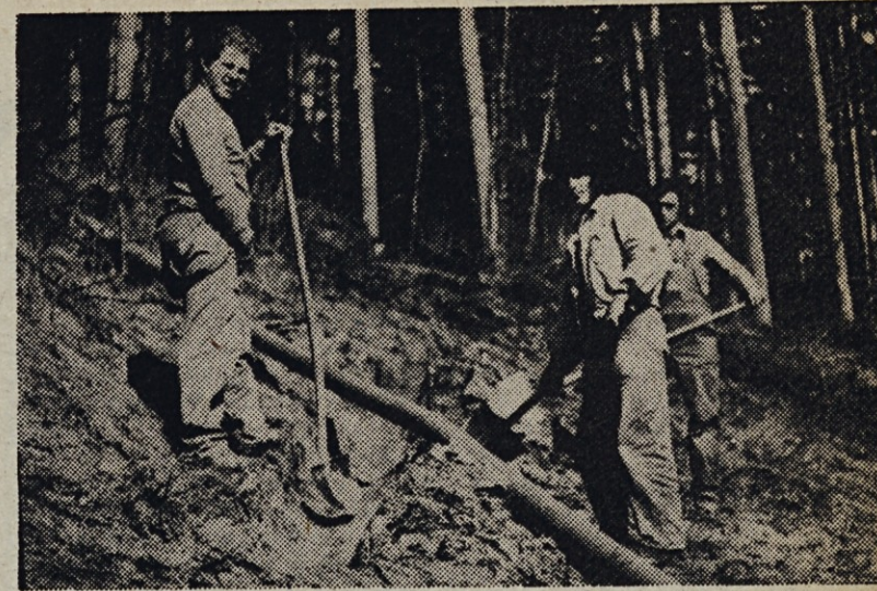
Močvirnost in plazovit teren na cesti za Radeljski prelaz ovira posamezne cestne odseke, tako da je potrebna sanacija le-teh
