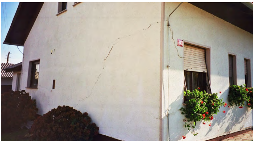
Sl. 3. Poškodbe na hiši iz centralnega dela Doline (poleg vrtine DI-5).
