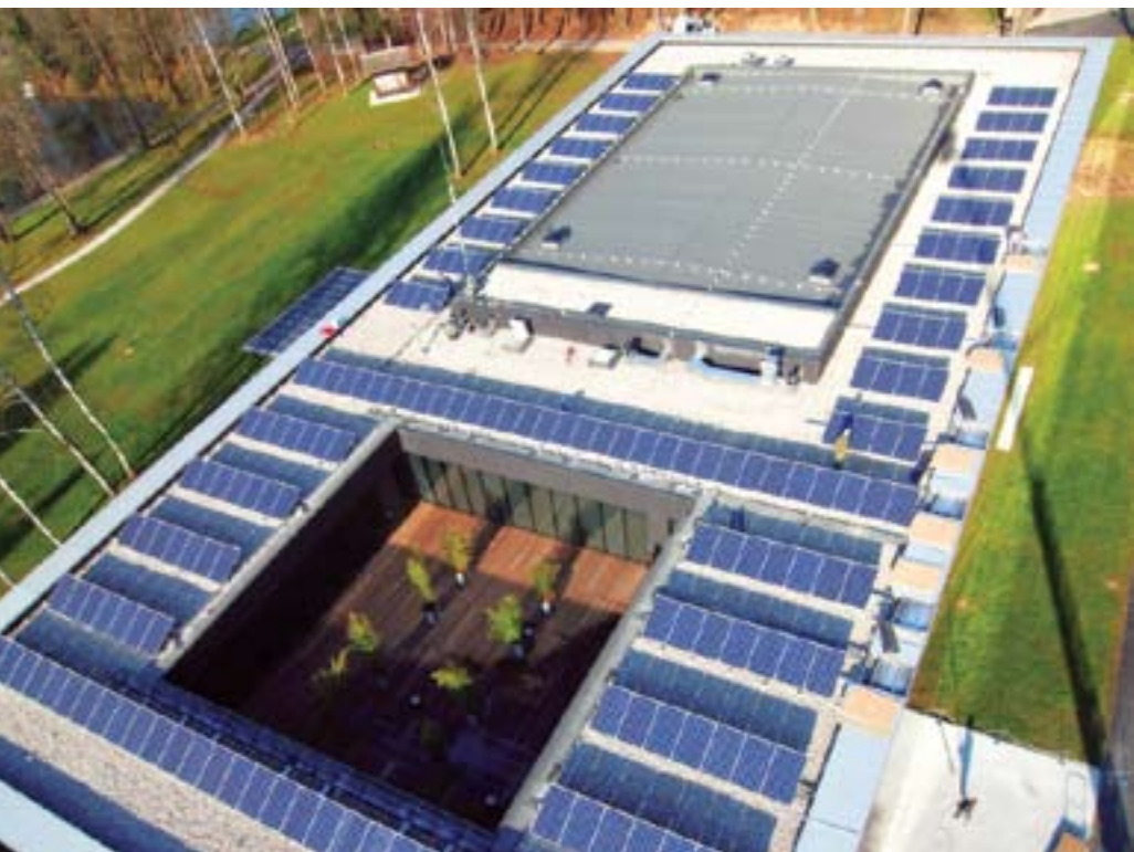
Sončni fotonapetostni elektrarni na kongresnem centru Brdo se bo konec leta 2008 pridružila tudi sončna elektrarna na strehi upravne stavbe Elektra Celje, d. d., v Celju.
