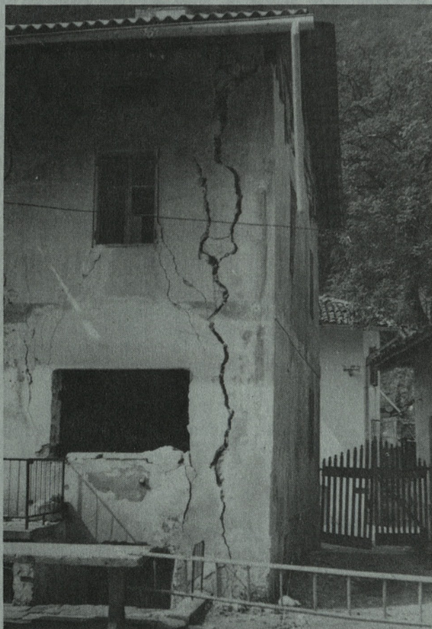
Slika 1: Začetek trganja zidov med potresom (Posočje, 1976. Foto J. Boštjančič)
