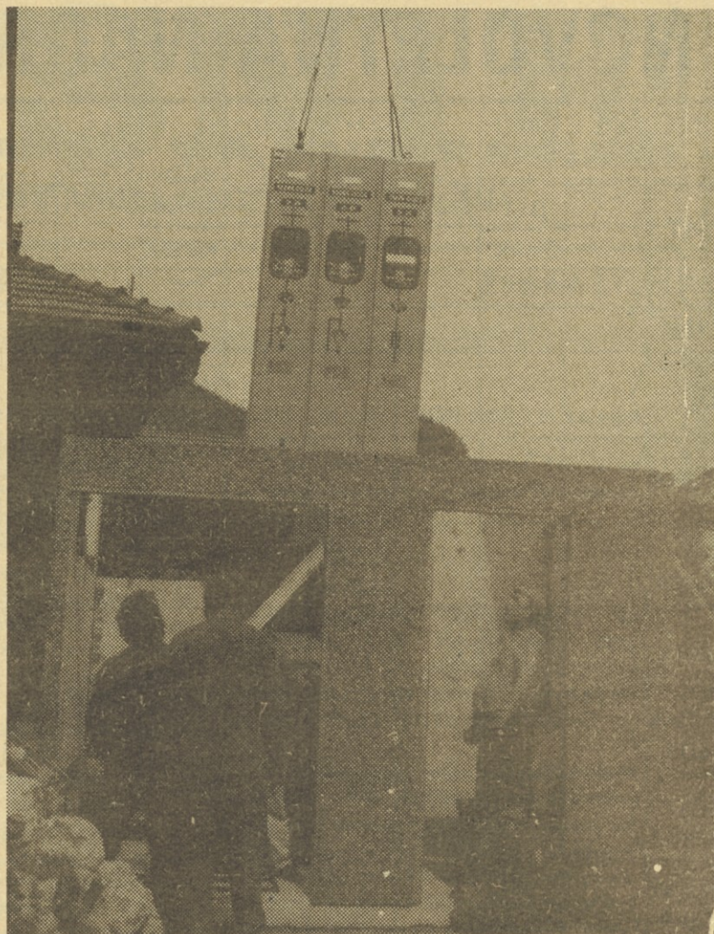
Vgrajevanje »srca«. Vgrajujemo domačo (IMP) elektro opremo za visoko in nizko napetost. Vso opremo je atestiral Inštitut »Milan Vidmar« in ustreza predpisom. Dobavni roki za opremo so mesec dni, če je na zalogi pa tudi manj. Oprema je v postaji lahko dostopna in zamenljiva.
