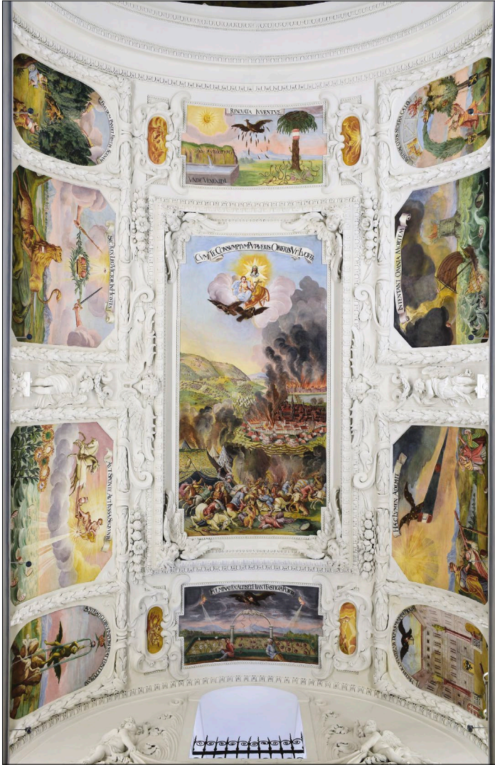
26. Joseph Antonio Serenio, Girolamo Rossi, Antonio Quadrio (Stuck), Franz Stainpichler (Fresken, zugeschrieben): Tonnengewölbe über dem Langhaus, 1688–1689, Katharinenkirche, Graz
