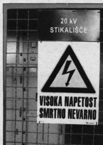
20 kV stikališče za lastno rabo elektrarne že deluje.
