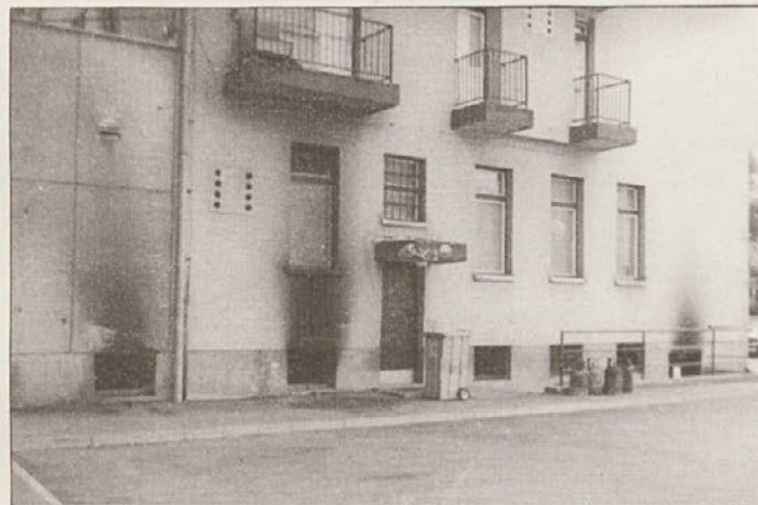
Skupni prostori (hodniki) v stanovanjskem bloku so močno okajeni.
