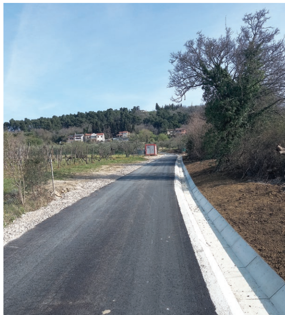
V zaselku ob Jadranski cesti potekajo še zaključna dela. / Sono ancora in corso i lavori conclusivi nella frazione lungo Strada dell'Adriatico. (Foto: Občina Ankaran / Comune di Ancarano)
