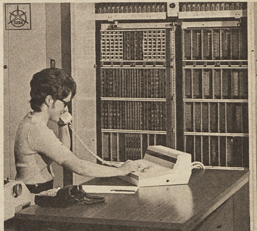
Domača elektronska zasebna avtomatska telefonska centrala EPABX 300.
