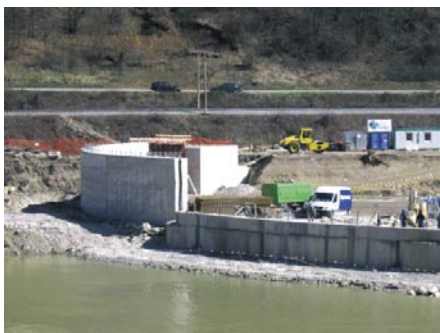
Slika 8 • Začasna gorvodna ločna pregrada; v ospredju stik z vodnjaško steno, v ozadju masiven oporni betonski blok
