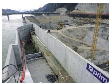
Slika 12 • Peti stember prelivnih polj z začasno dolvodno ločno pregrado in florisno lomljenim konzolnim zidom (skrajni levi del slike). Na desni je vidna ne odstranjena in neaktivna konzola vodnjaške stene
