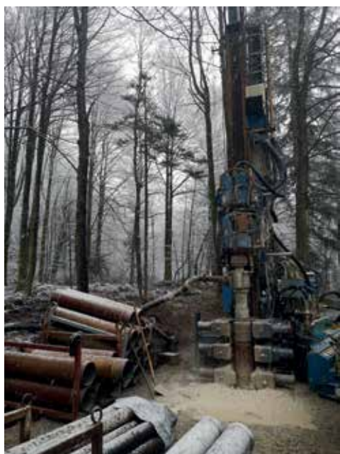
Izvajalec raziskovalno črpalne vrtine VZ-7 je konec novembra 2022 začel pripravljala dela na lokaciji vrtanja.
