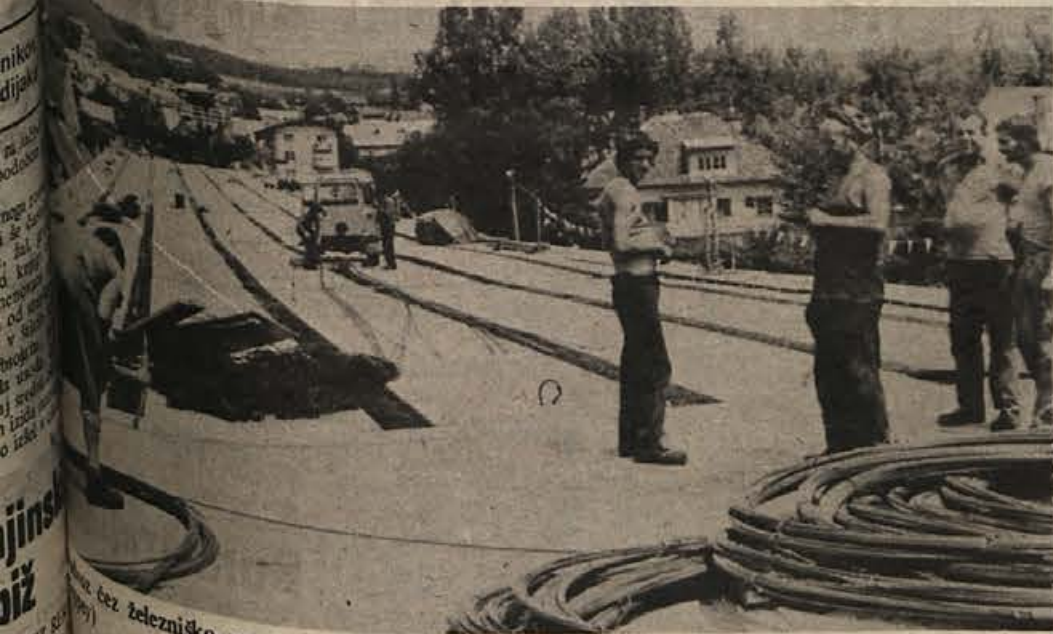
Novo železniško progo v Krškem požira ogromne količine železa in betona. (Foto: Jožica Teppey)
