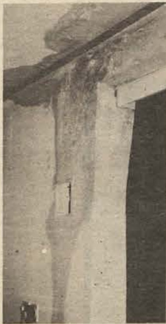
Takole pušča voda v stanovanju v Kidričevi 9 v Kočevju
