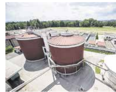
Centralna čistilna naprava Domžale - Kamnik
