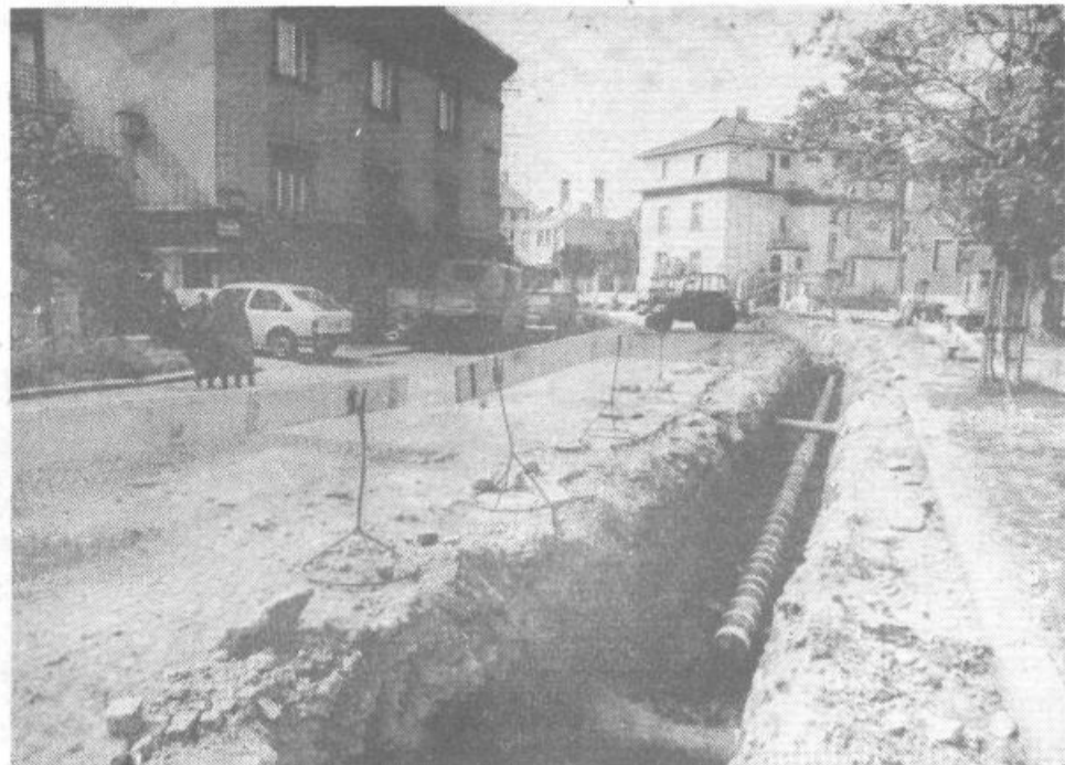
Kanal po Groharjevi cesti, od Teslove ulice pa vse do občinske stavbe, je bil strt v tolikšni meri, da je grozilo vdrtje ceste. Dotrajana je bila tudi plinska cev. Oboje, kanalizacijske in plinske cevi, je bilo zato nujno popraviti. Dela že tečejo, opravljata pa jih DO Vodovod-kanalizacija, TOZD Kanalizacija in DO Energetika, TOZD Plinarna. Po končanih teh popravilih pa bo seveda potrebno obnoviti tudi cestišče. Groharjeva ulica bo torej zopet prevozna v začetku avgusta, vsaj upamo tako!?
