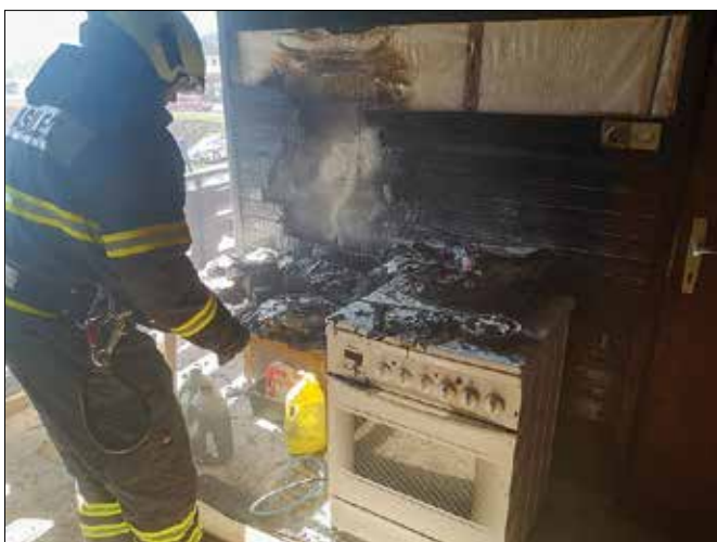
Po prvih ugotovitvah naj bi bil vzrok nesreče napaka v električni napeljavi štedilnika. (Fotodokumentacija PGD Okonina)
