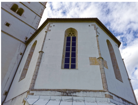
Ventilacijske mrežice. (foto: Jože Štukl)
