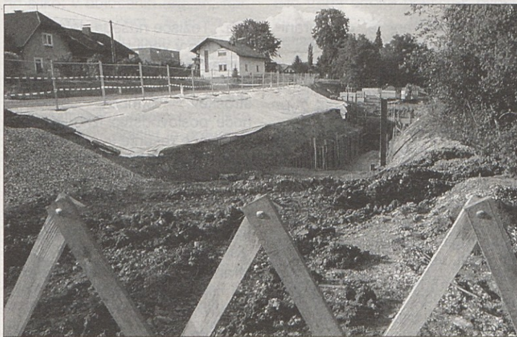
Milijonska škoda? Pričetek gradnje pliberške občinske kanalizacije ne bil zelo srečen. V Nonči vasi se je deželna cesta pogreznila in so jo morali na novo asfaltirati. Kdo bo plačal škodo, pa še ni čisto odločeno.
