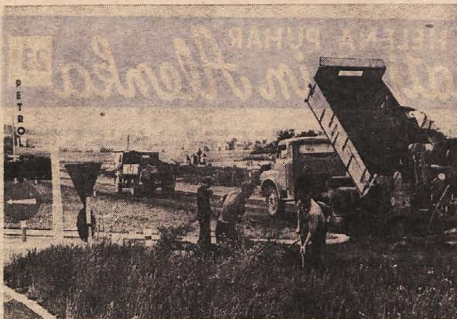
Razpokana in na več krajih udrt avtomobilska cesta pri Trebnjem je prejšnji teden dobila novo, precej debelo plast asfalta. (Foto: Legan)
