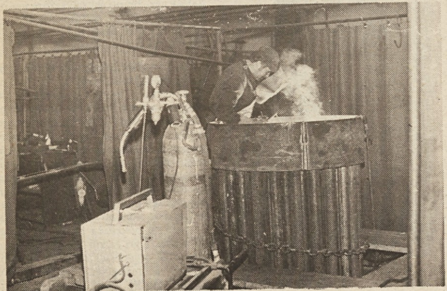
Stanko Kopinšek je testiran varilec; slikali smo ga ob kotlu Wanson z močjo 1,250.000 Kcal/h.
