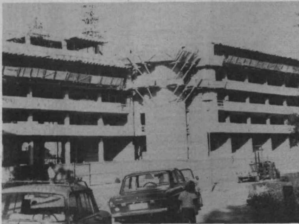
Poslovni center Lesnine bo zaradi tromesečne zamude pri gradnji, ki je nastala zaradi dodatnih del in sprememb prvotnega projekta, kmalu presegel ceno najdražjega ponudnika na licitaciji za oddajo del.
