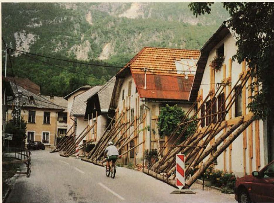
Prve sanacije poškodovanih objektov potresa, ki je bil 12.4.1998, so se pričele natanko 17.8.1998!
