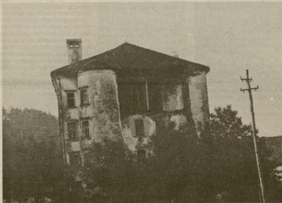
Zanemarjena podoba graščine Tabor ni v ponos nikomur, v njej trenutno gostuje ena družina, mizarska delavnica in občasno kakšen brezdomec. Ščasoma pa naj bi stavba, ki se pogreza sama vase, dobila podobo hotela visoke kategorije.
