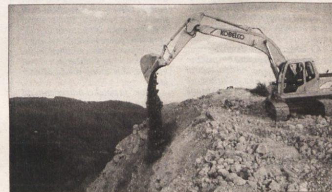
LOP PO RUDNIKU - Rudnik v zapiranju na Senovem je v teh dneh tarča mnogih hudih pogledov in besed jeznih in zaskrbljenih domačinov s Senovega, a tudi strojev. Po rudniku ali bolje po njegovi naravni strehi je ta čas udaril tudi bager na fotografiji. Bager je v družbi buldožerja ravnal hrib nad Senovim. Domačini po očitnih namerah strojev sklepajo, da bo mehanizacija znižala hrib nad nekdanjo rudniško jamo, kar naj bi zmanjšalo škodljivi vpliv rudnika na senovska tla v prihodnosti. Med domačini so nekateri nedavno izjavili, da jih kot lastnike zemljišča na vrhu zdaj prekopane hriba ni nihče obvestil o načrtovanem prekopavanju. (Foto: M. Luzar)
