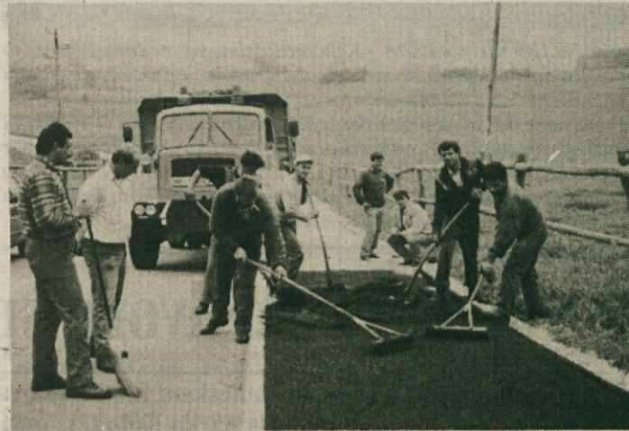
PLOČNIK POD TRŠKO GORO - V soboto so delavci novomeškega Cestnega podjetja asfaltirali pločnik, ki vodi od glavne ceste v Mačkovcu mimo srednje kmetijske šole do vasi Sevno pod Trško goro. Pločnik ob tej kar prometni cesti bo še posebej dobrodošel za dijake kmetijske šole, ki so doslej v šolo in iz nje morali hoditi kar po cesti. (Foto: A. B.)
