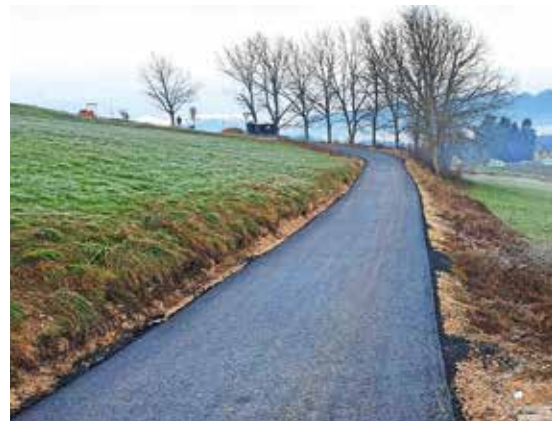
Izvajalec je asfaltiranje zaključil tik pred novim letom. / Foto: arhiv Občine Medvode
