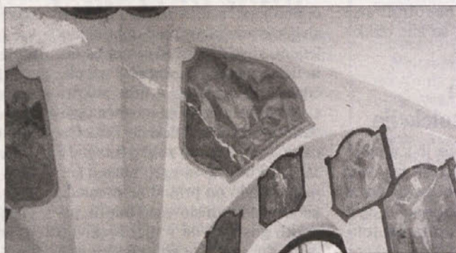
Razpoka v stranski kapeli sv. Frančiška Pavelskega je že poškodovala stenske slike, delo Janeza Wurzerja iz Salzburga.
