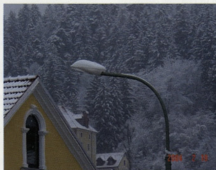
Ulična razsvetljava po obnovi.
