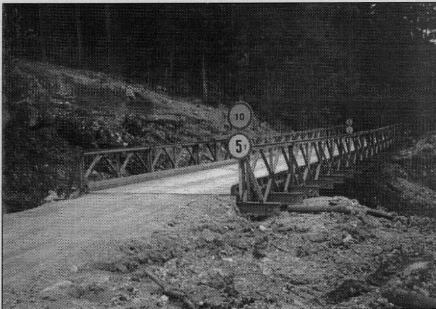
"Nov" most omogoča "normalno" prevoznost preko plazu
