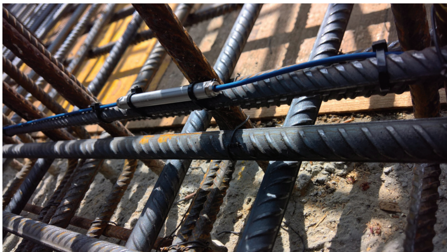
Slika 5 • Optični senzor za merjenje temperature v spodnji coni konstrukcije, ki smo ga namestili ob oporniku 1
