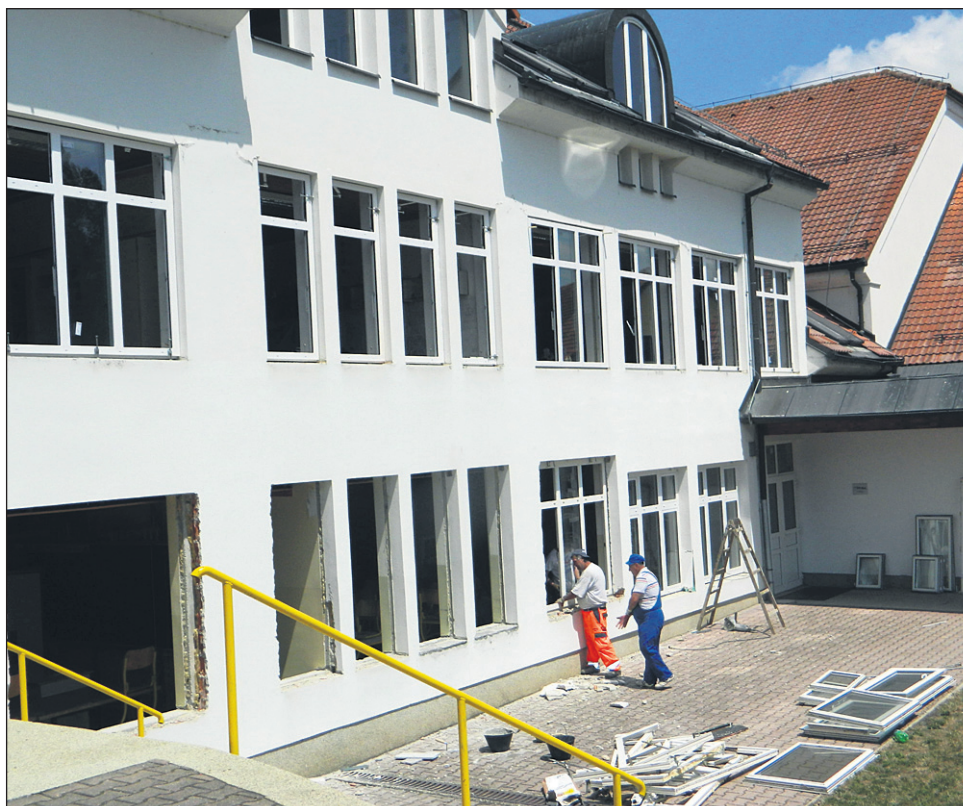
Delavci v teh dneh na šolski zgradbi v Vidmu odstranjujejo stara in vgrajujejo nova, troslojno zastekljena okna v pritličju; preden se bodo preselili v nadstropje, si bodo postavili gradbeni oder.
