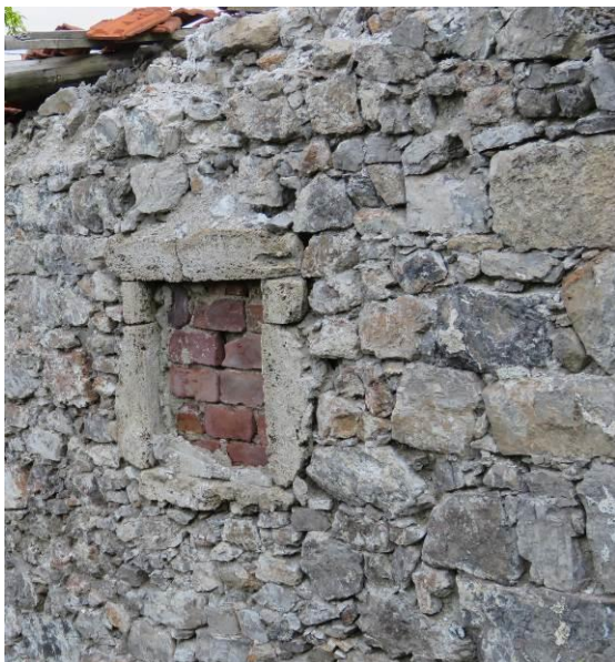
Slika 391: Detajl stene brez odpadlega ometa razkriva kvalitetno gradnjo in okenske okvirje iz lehnjaka, nekoč so bili celo že povečani.
