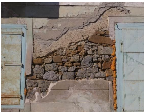
Slika 150: Vpogled v uporabljene materiale – prevladuje trdi sivi in mehkejši rjavi peščenjak, ki ga najdemo ob Kolpi. Le reprezentančni okvirji oken in vrat v vasi so iz kvalitetnega sivega apnenca.
