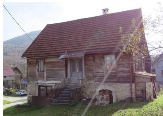
Slika 97: Zgoraj lesena hiša s predalčno leseno konstrukcijo. Spodnji desni kletni portal je iz 1880-ih, jarmičaste oblike; kamnrite stopnice.
