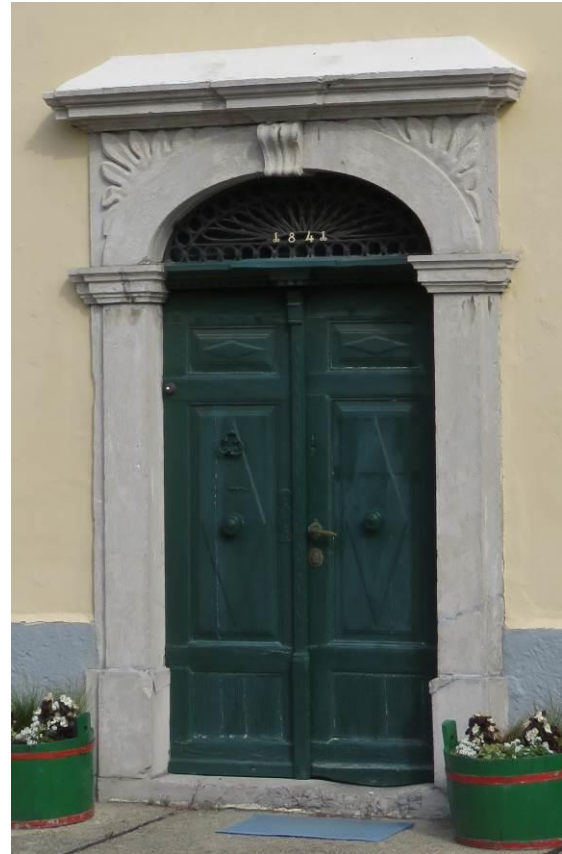
Slika 395: Bogat neobaročni portal s kovano letnico 1841 in rastlinskim okrasom. Verjetno je tu že od začetka in ni sočasen s kovano letnico, ki je bila morda dodana kasneje.
