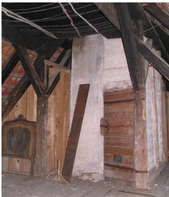
Slika 429: Sušilo na zgornji podstrehi z vhodnimi vrati v dimnik.
