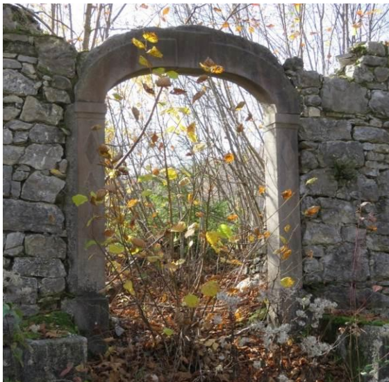
Slika 72: Vhodni portal ene od redkih zapuščenih hiš v Malih Dragah na poti iz Razdrtega. Stene iz apnenca niso grajene s poravnanimi skladi preko celotne stene, saj je gradnja zaradi prevokotnih oblik materiala dovolj stabilna že brez poravnav.
