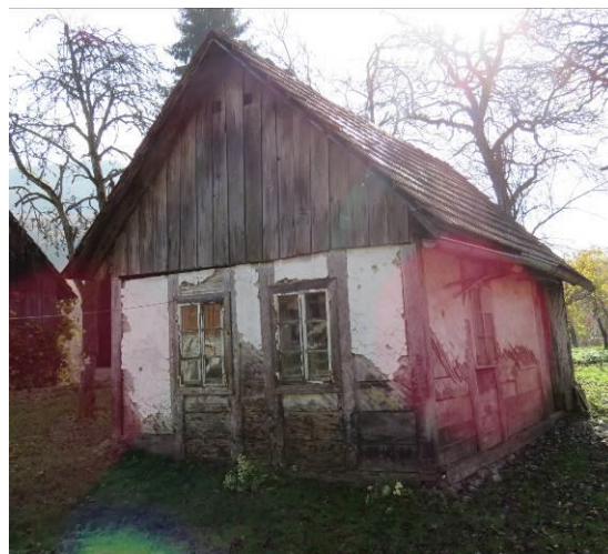
Slika 101: Mala hišica še s tretje strani. Okni v hišo sta bili le dve. Na stenah je vidna vertikalna nosilna konstrukcija. Le vmesna polja z lesenimi polnili so poletvana in ometana z apnenim ometom.
