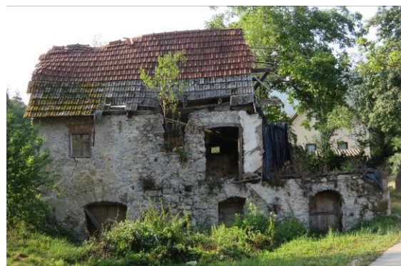
Slika 361, 362: Zgoraj fotografija stare Kapševe hiše Stare Žage 1, preden se je porušil desni del. Spodaj stanje julija 2015.
