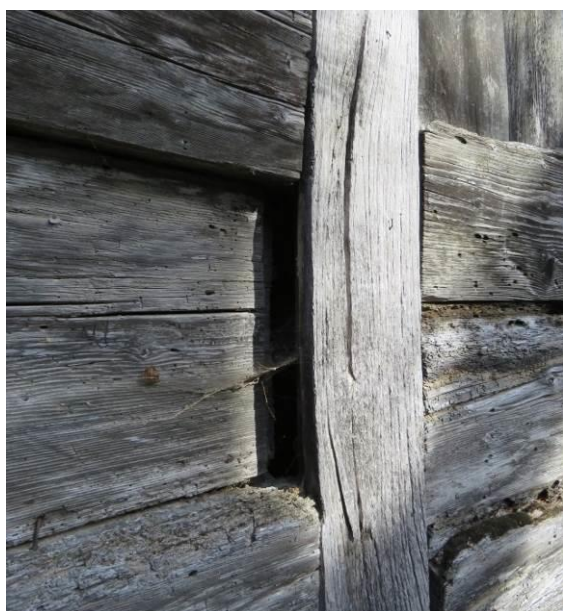
Slika 109: Detajl spoja lesene kasetne gradnje iz Malih Drag. Vertikalni nosilec je hrastov, horizontalni plohi verjetno jelovi.
